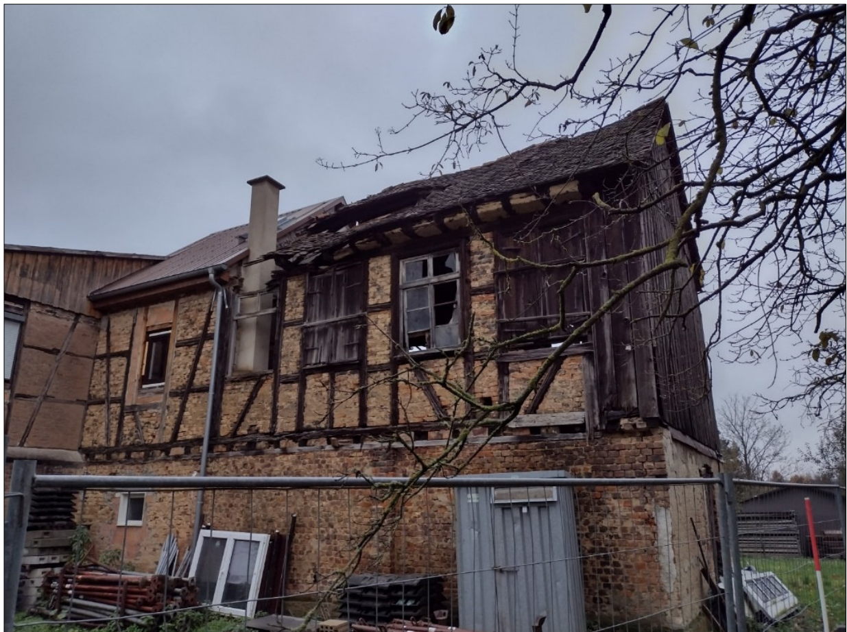
Abbildung 22: Scheune in direkter Nachbarschaft des Friedhofs, mit eingestürztem Dach, zahlreichen Spalten und Zugängen.
